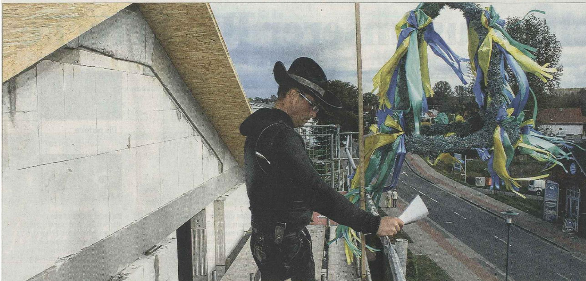
Von Zimmerer-Bauleiter Frank Rühlemann kam gestern der Richtspruch für das „Strandhaus“ in Glowe. Hier stand einst die Kaufhalle des Ortes.
