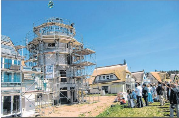
Die Bauarbeiten in der Wohnanlage „Admiralsresidenz“ Breege gehen voran. Jetzt war Richtfest am „Leuchtturm“.
